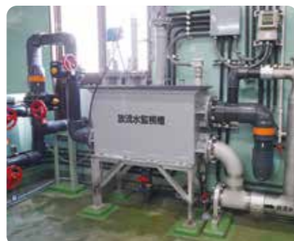
放流水監視槽
