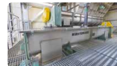
汚泥搬出装置
