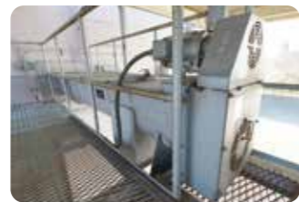
汚泥搬出装置
