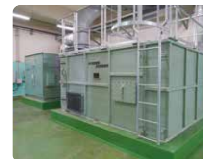
高中濃度活性炭脱臭塔
